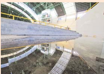
INSTALACIONES ANEGADAS DE AGUA.
