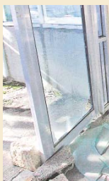
PUERTAS EN MAL ESTADO.
