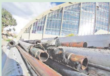
EL TECHO DEL CENTRO DE ALTO RENDIMIENTO, PERFORADO (ARRIBA). COLCHONETAS EN MAL ESTADO DE LA GIMNASIA. (ABAJO) MATERIAL Y RAJADURAS EN EL PISO.
