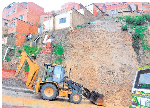
AL FILO DE LA DESGRACIA. CASAS SOSTENIDAS QUE ESTÁN A PUNTO DE VENIRSE ABAJO Y UN TRACTOR QUE TRATA DE REFORZAR EL DÉBIL TERRENO QUE CON LA PERSISTENTE LLUVIA SE VA DEBILITANDO MINUTO A MINUTO.
