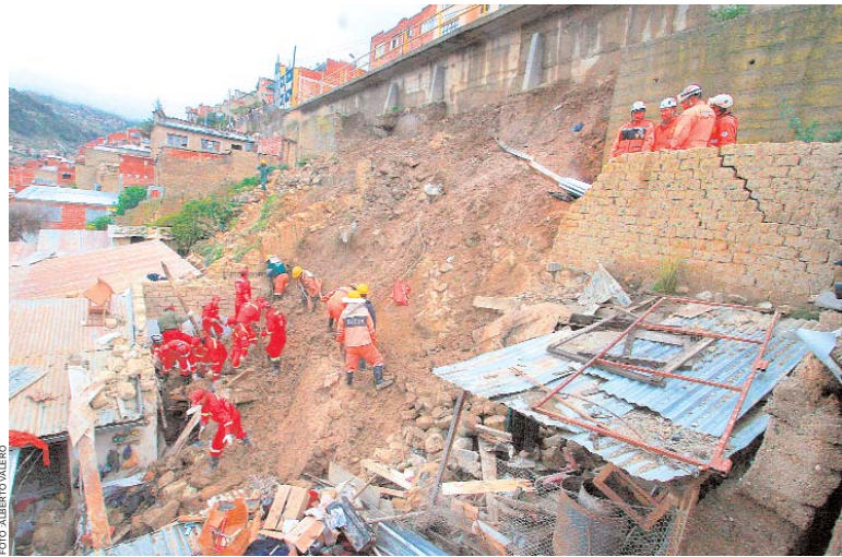
UNA CASA FUE SEPULTADA POR EL DESLIZAMIENTO DE UN MURO QUE APLASTÓ A TRES MIEMBROS DE UNA FAMILIA. LOS VECINOS RESPONSABILIZAN A LA NEGLIGENCIA DE LOS FUNCIONARIOS MUNICIPALES ENCARGADOS DEL PLAN BARRIOS DE VERDAD Y ÉSTOS ACUSARON A LA EMPRESA REALIZABA LOS TRABAJOS EN EL SECTOR.
