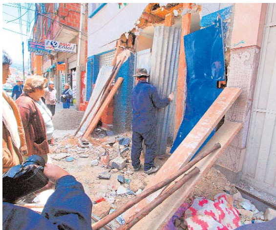
EL CHOQUE DE UN CAMIÓN OCASIONÓ LA CAÍDA DE UN MURO DE UNA VIVIENDA Y EN LA TIENDA DE INTERNET QUEDARON DESTRUIDOS VARIOS EQUIPOS DE COMPUTADORAS.
