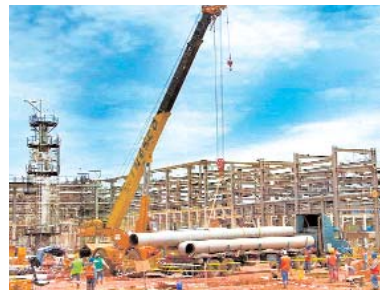
CAMPO HIDROCARBURIFERO MARGARITA-HUACAYA.
