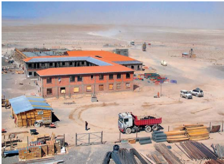
PLANTA PILOTO DE CARBONATO DE LITIO EN EL SALAR DE UYUNI.
