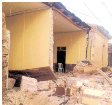
UNA VIVIENDA TOTALMENTE DESTRUIDA EN LA REGIÓN DE SAN MARCOS DONDE FUE EL EPICENTRO DEL TERREMOTO.
