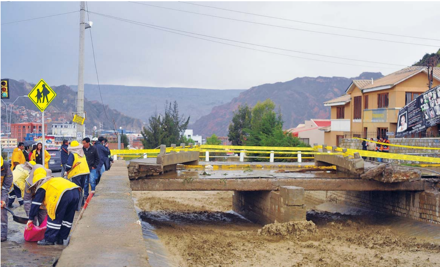
LUEGO DE UNA TORRENCIAL LLUVIA, LAS AGUAS GENERARON EL DESPLAZAMIENTO DE UN LADO DE LA ACERA PEATONAL DEL PUENTE QUE DA AL COLEGIO FRANCO BOLIVIANO, DONDE SE PRODUJO EL DESBORDE DEL RÍO ACHUMANI.
