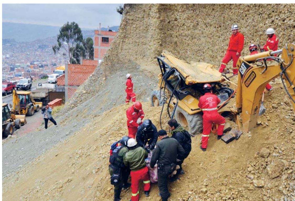
DESPLAZAMIENTO DE TALUD EN UNA CONSTRUCCIÓN CLANDESTINA CAUSÓ LA MUERTE DEL OPERADOR TRACTORISTA DANIEL POMA PINTO, EN LA ZONA FINAL PERIFÉRICA.
