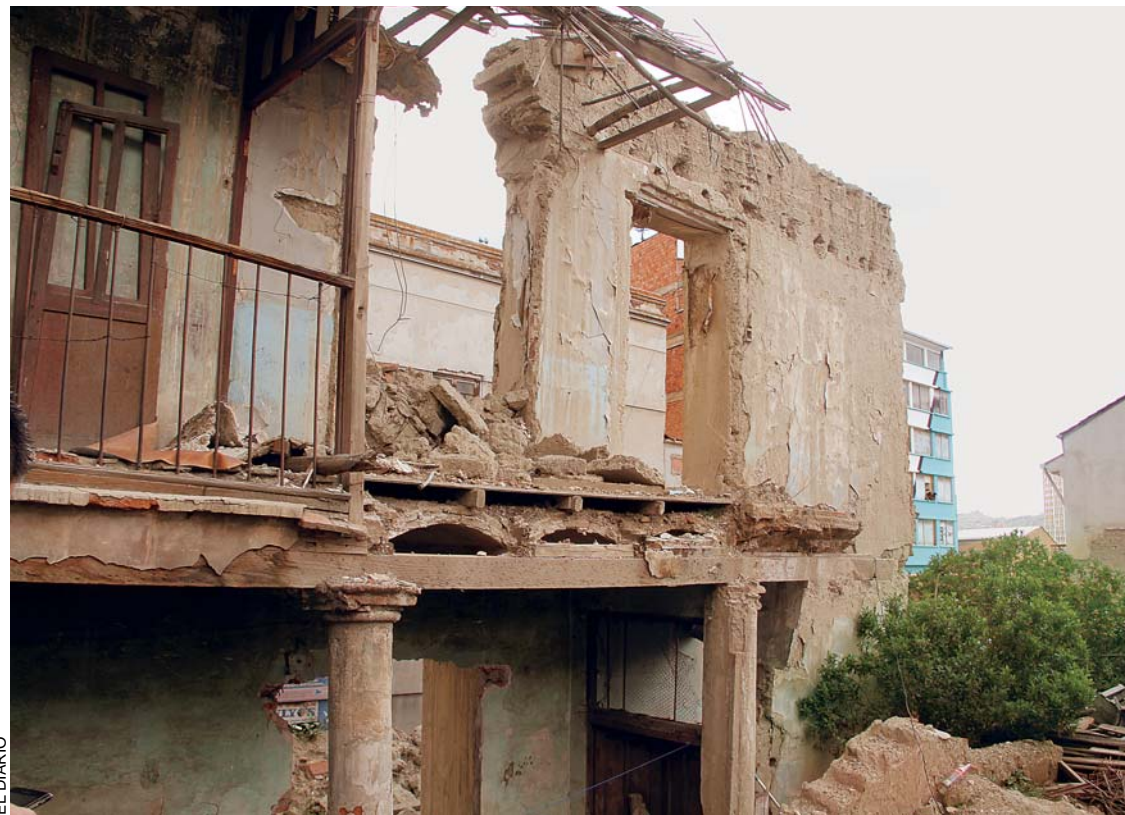
VARIOS INMUEBLES PATRIMONIALES ESTÁN EN RIESGO DE DERRUMBARSE. ESTE ES EL CASO DEL INMUEBLE UBICADO ENTRE LAS CALLES COMERCIO Y BUENO.
