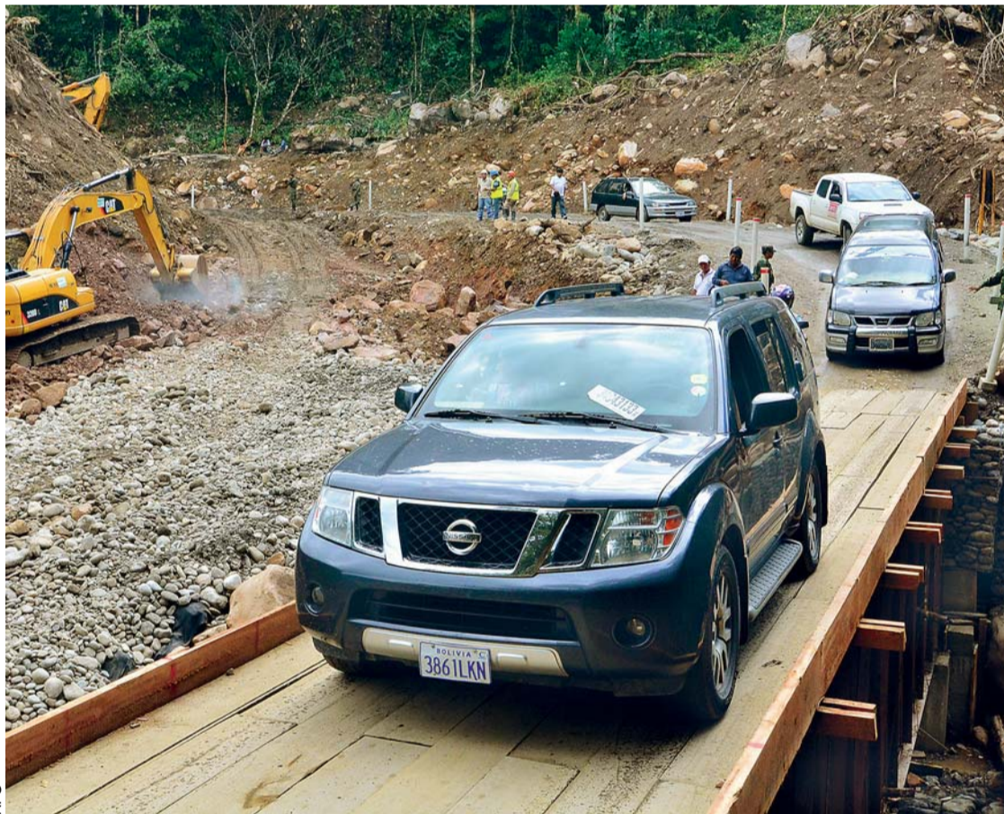
LA ZONA DE EL SILLAR ES CONFLICTIVA EN ÉPOCA DE LLUVIAS, LA VÍA ES INTRANSITABLE Y CADA AÑO EL GOBIERNO DESTINA SOLUCIONAR LOS PROBLEMAS QUE CAUSA LA TEMPORADA.
