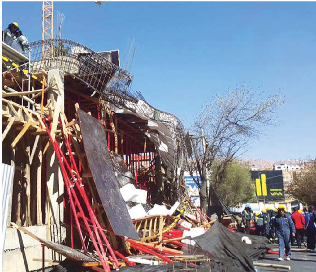
ESTRUCTURA CAYÓ CAUSANDO HERIDAS A PERSONAS.
