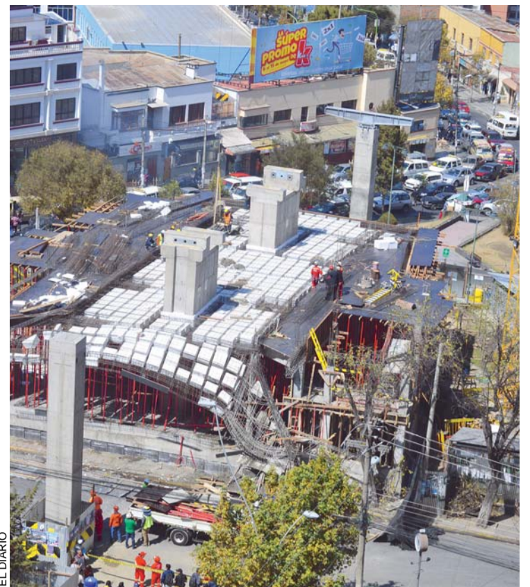
VISTA AÉREA DE CÓMO QUEDÓ EL SECTOR DESPUÉS DEL COLAPSO.
