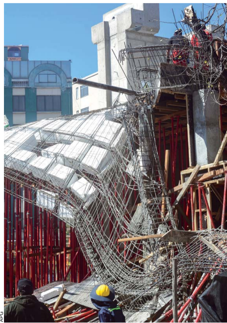
ESTRUCTURA DE LA LÍNEA BLANCA DEL TELEFÉRICO UBICADA EN LA PLAZA SAN MARTÍN QUEDÓ SERIAMENTE AFECTADA.
