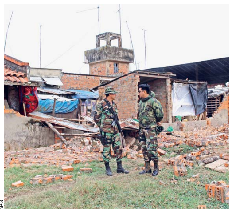
EL MURO DEL PENAL DE MOCOVÍ AFECTADO POR EL VIENTO.
