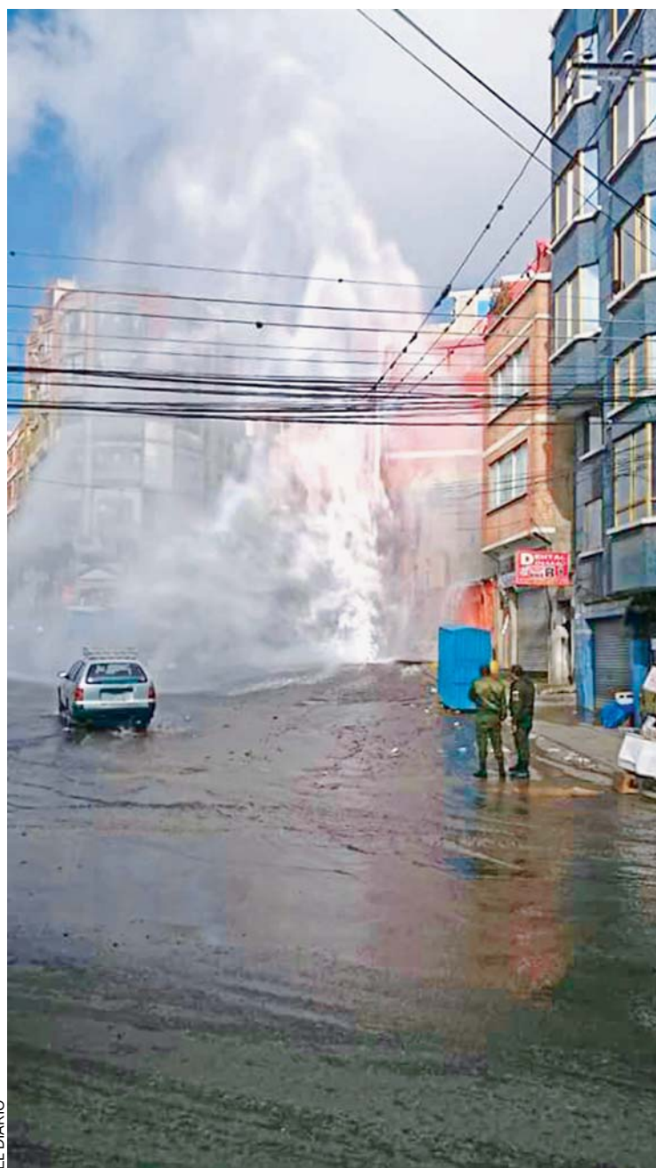
LA ROTURA DE UNA TUBERÍA CAUSÓ LA PÉRDIDA DE INGENTES CANTIDADES DE AGUA POTABLE EN LA URBE PACEÑA.
