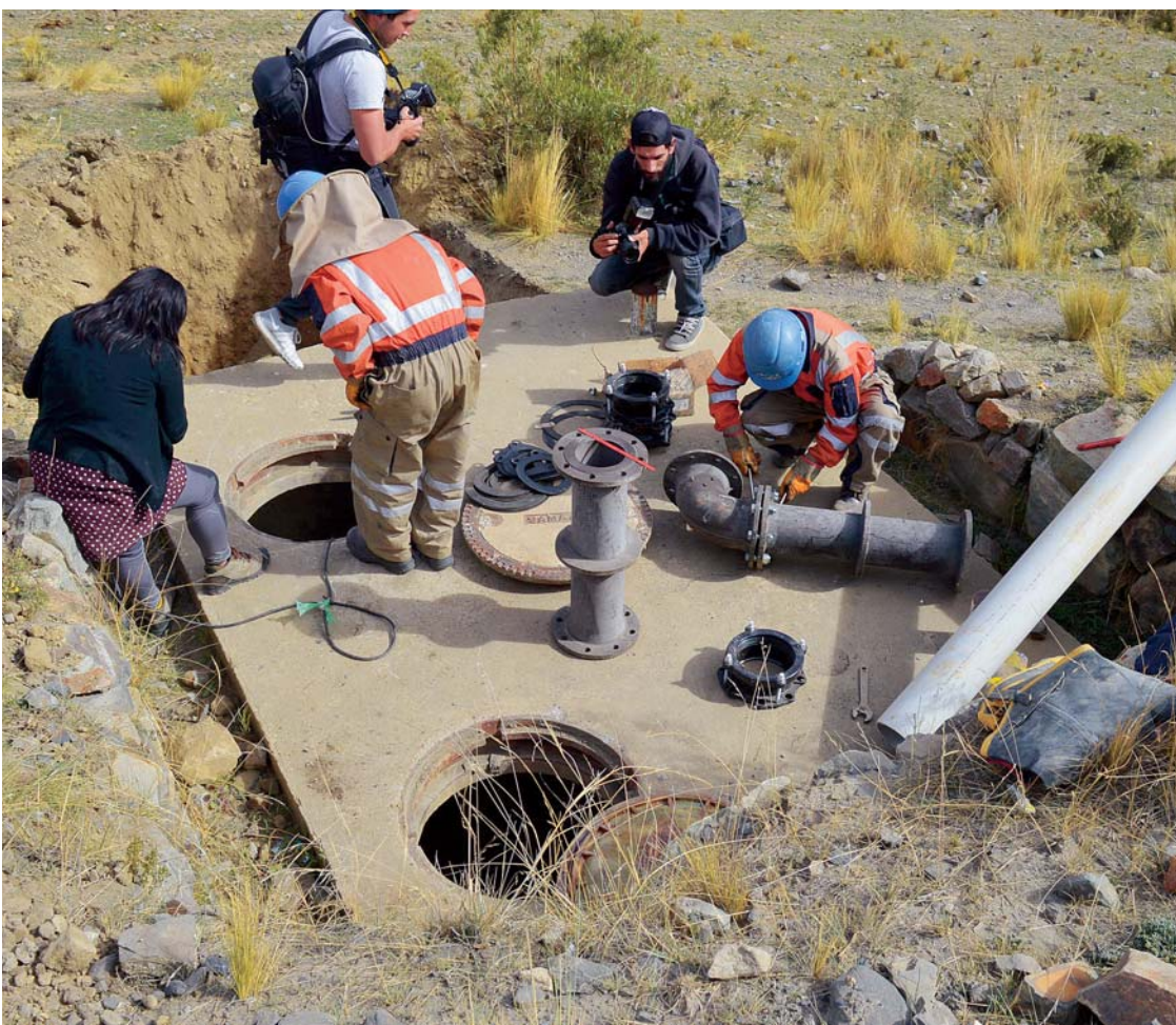
LAS VÁLVULAS DE LA URBE PACEÑA SON ANTIGUAS Y LAS CAÑERÍAS FRÁGILES CAUSAN PREOCUPACIÓN EN LA CIUDADANÍA.
