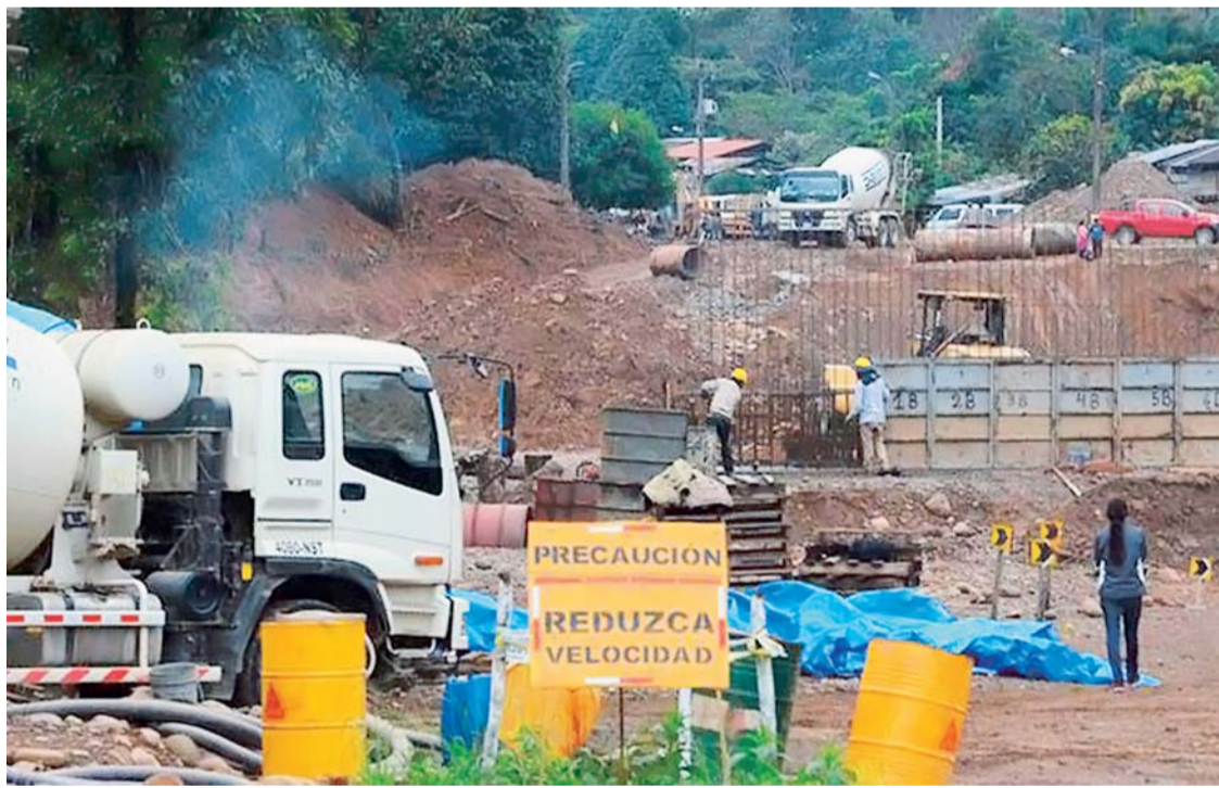
EL PERSONAL Y LA MAQUINARIA EN LA CONSTRUCCIÓN DEL PRIMER PUNTE A LA ALTURA DEL RÍO ISIBORO AL INTERIOR DEL TIPNIS. LA OBRA ESTÁ A 20 MINUTOS DE LA POBLACIÓN DE ISINUTA.
