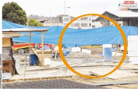
LUGAR DONDE SE REGISTRÓ EL DESPLOME DE LA PLATAFORMA.
