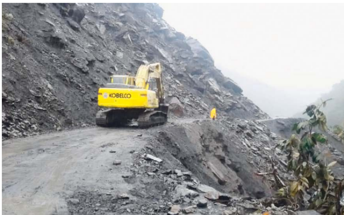
MAQUINARIA PESADA DE LA ABC TRABAJA PARA RESTABLECER EL TRÁNSITO VEHICULAR EN LOS YUNGAS, TRAS LOS DERRUMBES REGISTRADOS.
